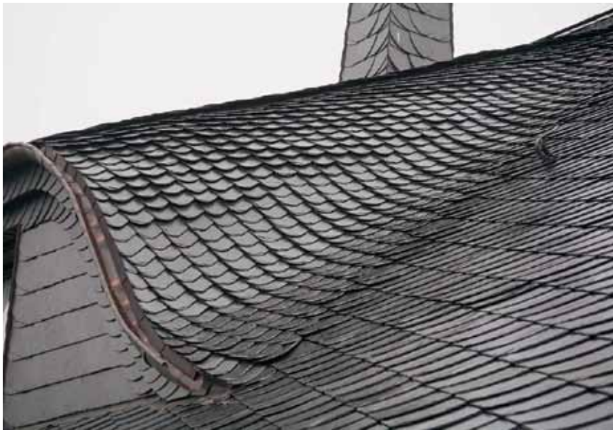
Trotz leicht sperrendem Schiefer auf der Gaube dürfte mit keinen negativen Auswirkungen gerechnet werden, sodass ein Abriss der Deckung mit Neuerstellung unverhältnismäßig gewesen wäre.
