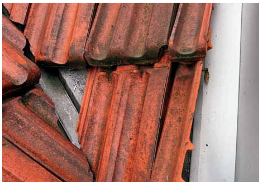
Die völlig unterdimensionierten Abmessungen des untergelegten Metallanschlusses lassen einen Rückbau mit anschließender fachgerechter Neuerstellung des Anschlusses für die erforderliche Regensicherheit als notwendig erscheinen.
