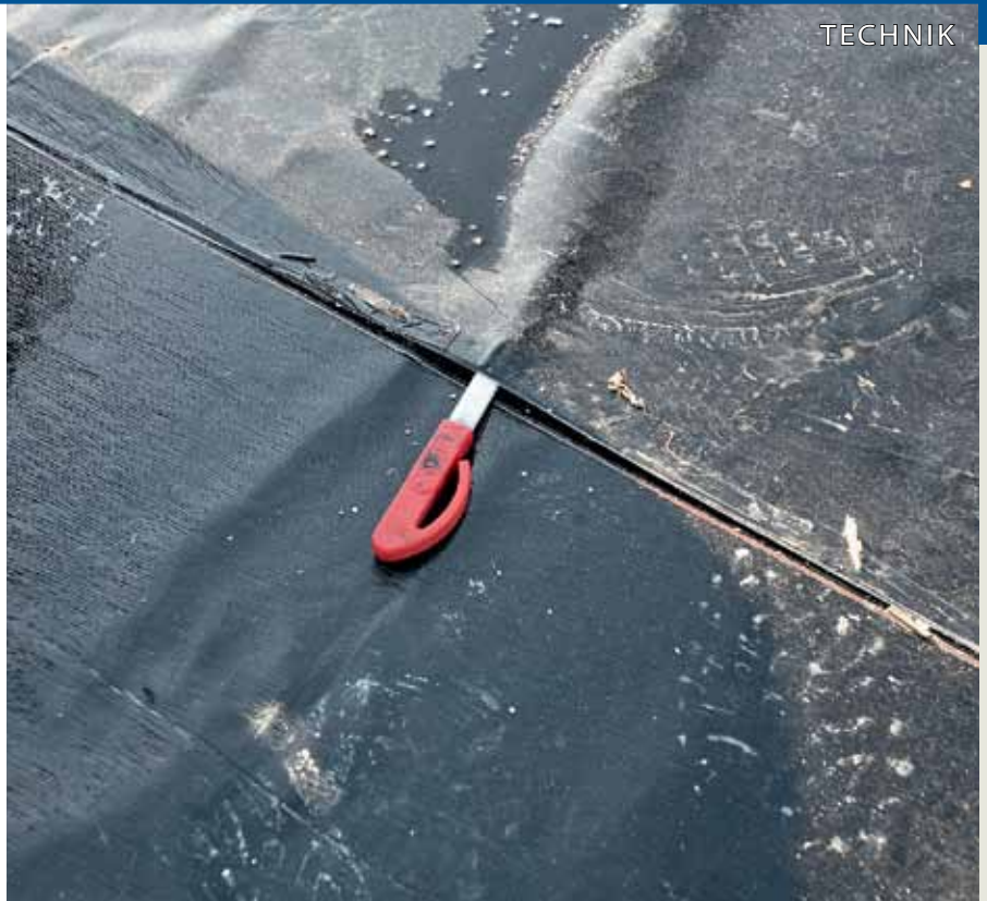
Das Niederschlagswasser konnte ungehindert über die Fehlstellen der ersten Lage in das Dachschichtenpaket gelangen.
