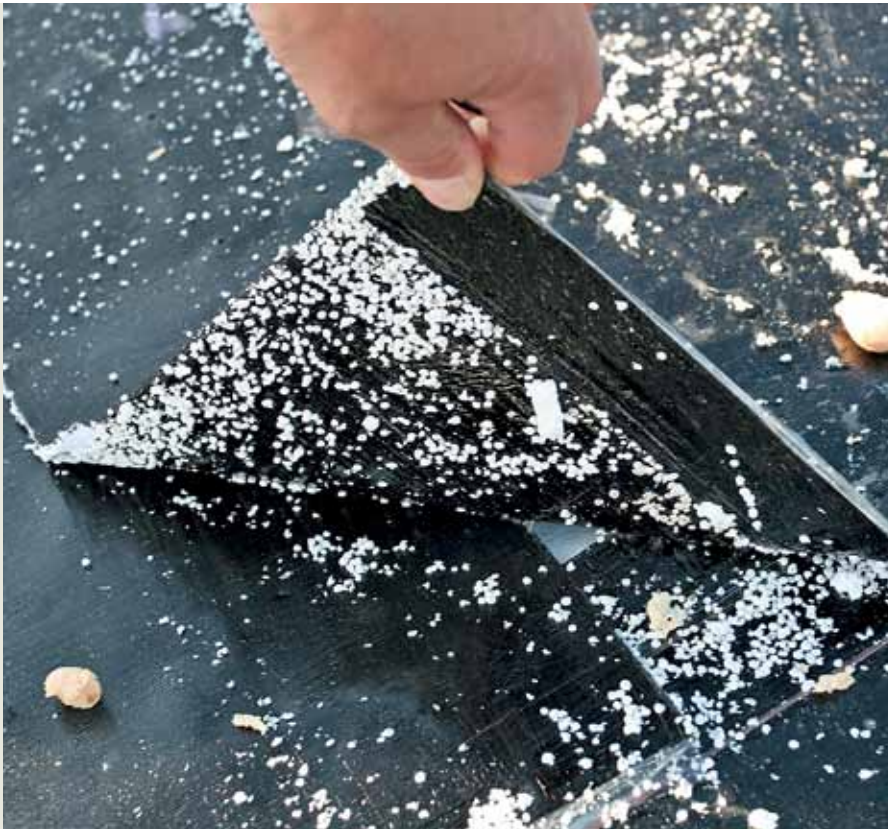
Ein nachträgliches Verschweißen der verunreinigten Nähte wäre insbesondere im selbstklebenden Bereich kaum möglich gewesen, so dass eine verschweißte Überdeckung von 80 mm gemäß Flachdachrichtlinie nicht erzielt worden wäre.
