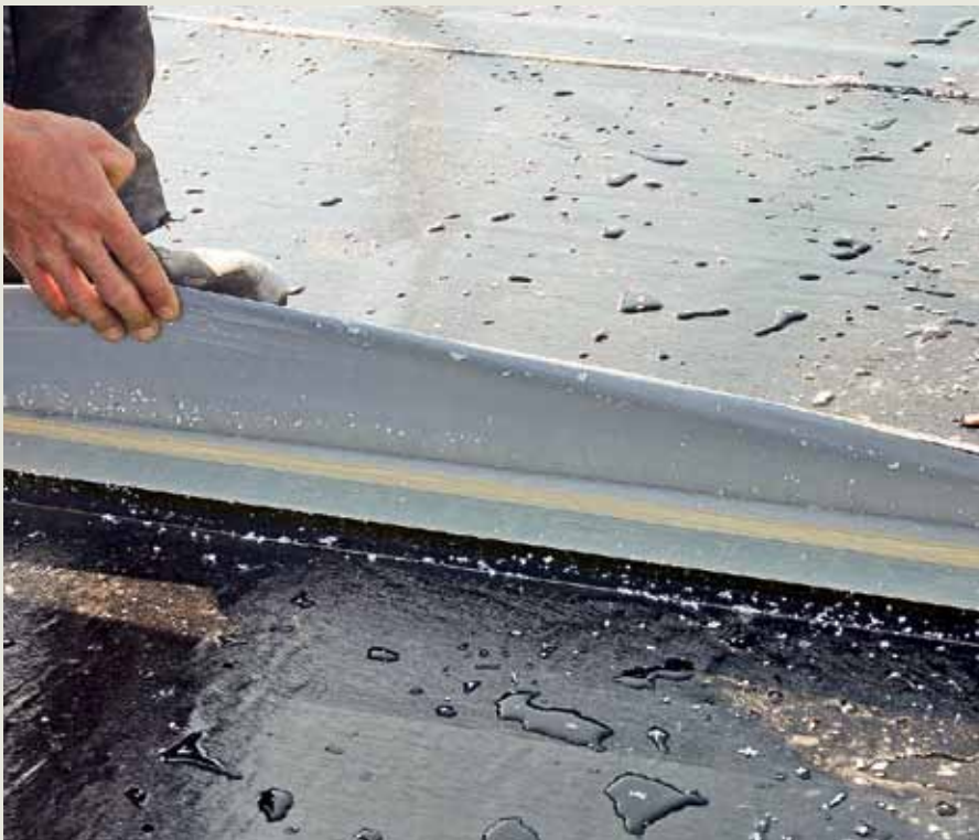
In einigen Bereichen konnten die Bahnen nicht einmal im selbstklebenden Bereich des Schweißrandes miteinander verklebt werden, da es versäumt wurde, die Schutzfolien zu entfernen.
