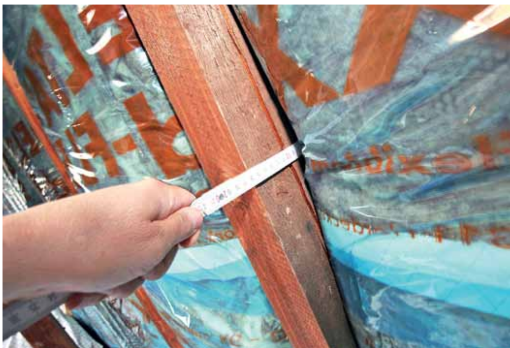
Trotz der luftdicht erstellten Anschlüsse der Dampfsperre untereinander und in den Anschlussbereichen, besteht aufgrund der mangelhaften Verlegung die Gefahr von Tauwasserausfall im Bereich der Sparren.
