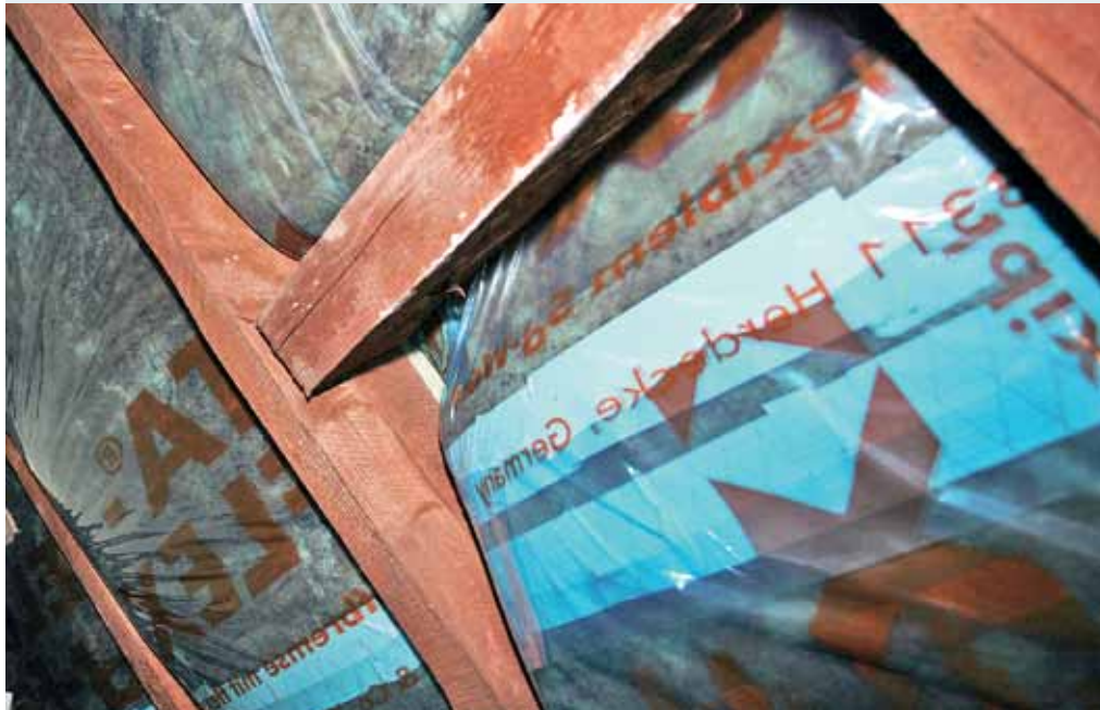
Die Dampfsperre wurde auf Spannung verlegt, so dass sie regelrecht vom Sparren weggezogen wurde und dort große Lücken respektive Wärmebrücken hinterlassen hat. Tauwasser hatte bereits Spuren am Holz hinterlassen.
