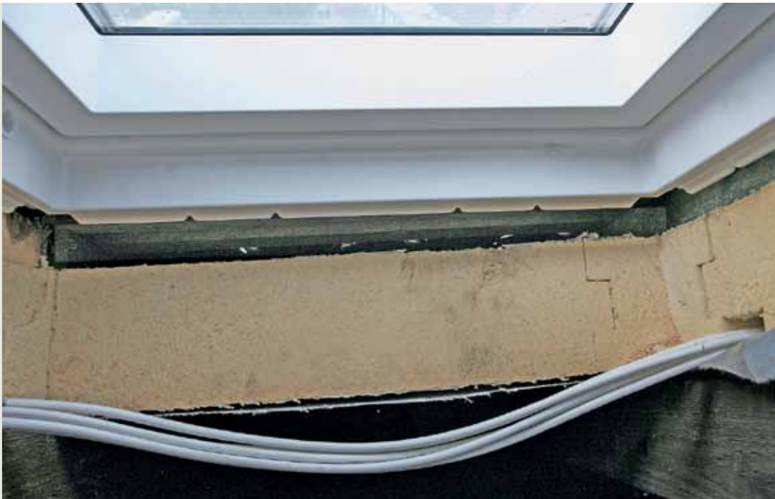
Weder die Aufsparrendämmung noch die Dampfsperre wurden fachregelkonform an das Dachflächenfenster angearbeitet.
