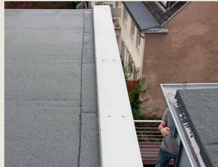
Die Dachrandabdeckungen wurden direkt mit Schrauben und Unterlegscheiben befestigt statt indirekt mit Haften.
