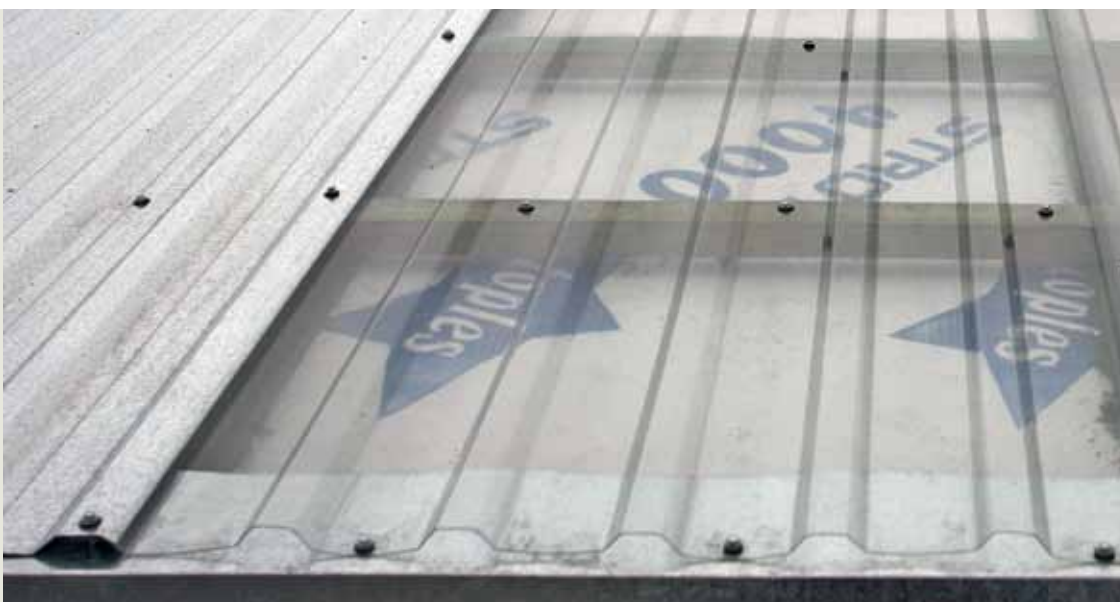
Kunststoffprofiltafeln müssen grundsätzlich in den Obergurten befestigt werden und nicht wie dort geschehen in den Untergurten.
