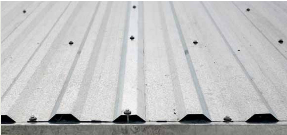
Die Befestigung der Metallprofiltafeln im unteren Bereich des Traufeneinlaufblechs birgt aufgrund der relativ freiliegenden Perforation die Gefahr des Wassereintritts.
