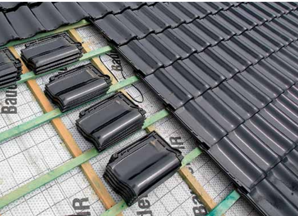
Bei der Begutachtung zeigte sich, dass die Traglattung fachgerecht ausgeführt wurde. Gleichzeitig stellte sich aber heraus, dass das gesamte Dach nicht geklammert wurde.
